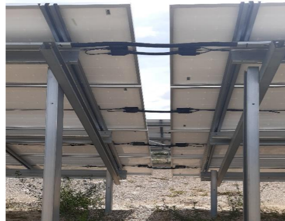
Figure 5 - Câblage sous modules
